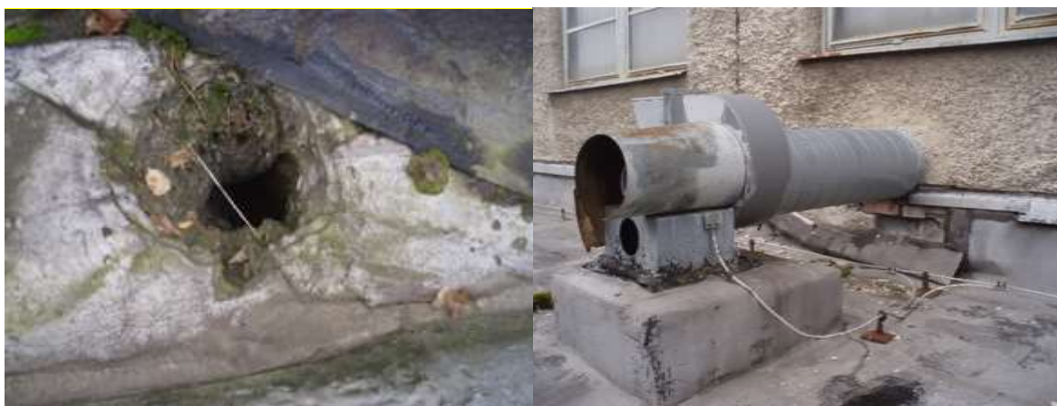
Jedna z vpustí do vnútorného zvodu dažďovej vody.
