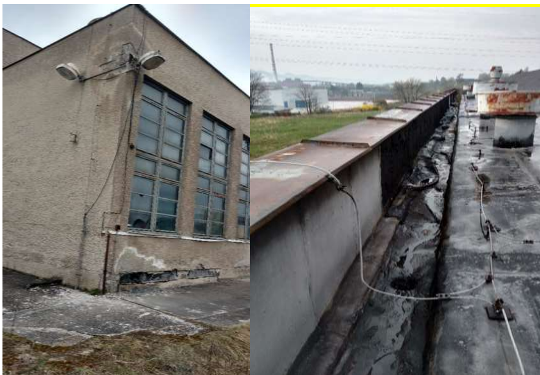
Žlab zvodu dažďovej vody-rozpraskaná opadnutá streš.krytina z atiky.
